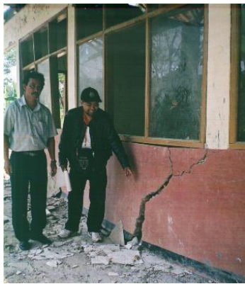
a. Bagian depan SD Ciptalaksana, Kp. Celak retak akibat Gempabumi (Saputra, 2005)
