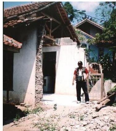
b. Depan rumah di Kp. Bojongsalam, roboh akibat getaran gempabumi (Saputra, 2005)
