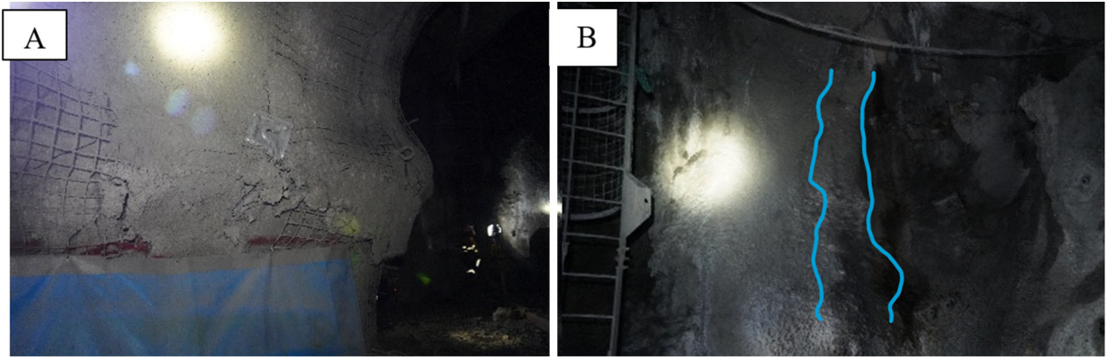
Gambar 3 Unravelling Shotcrete di Area Bottom Chamber (Gambar A) dan Tetesan Air Tanah di Dekat Vertical Raise (Gambar B) (Dokumentasi Pribadi)
